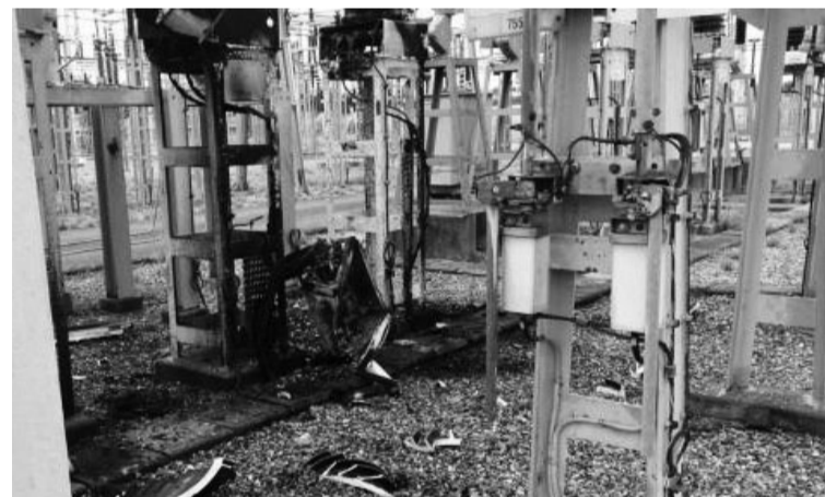
Un combiné de mesure EJ33 après explosion
